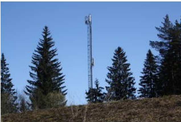
Tukiasemamasto ja tukiasema
